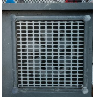
Ventilateurs à l'intérieur de l'unité CVC
